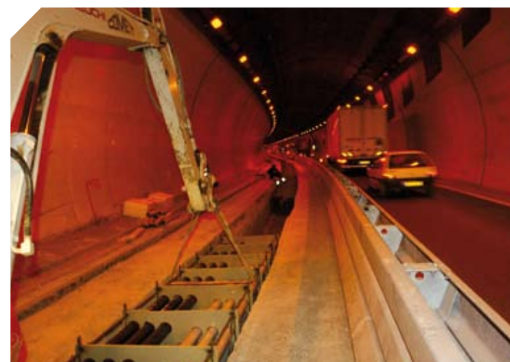
▲ Tous les câbles des réseaux primaires (énergie ou transmission des données) seront à l'abri du feu.
